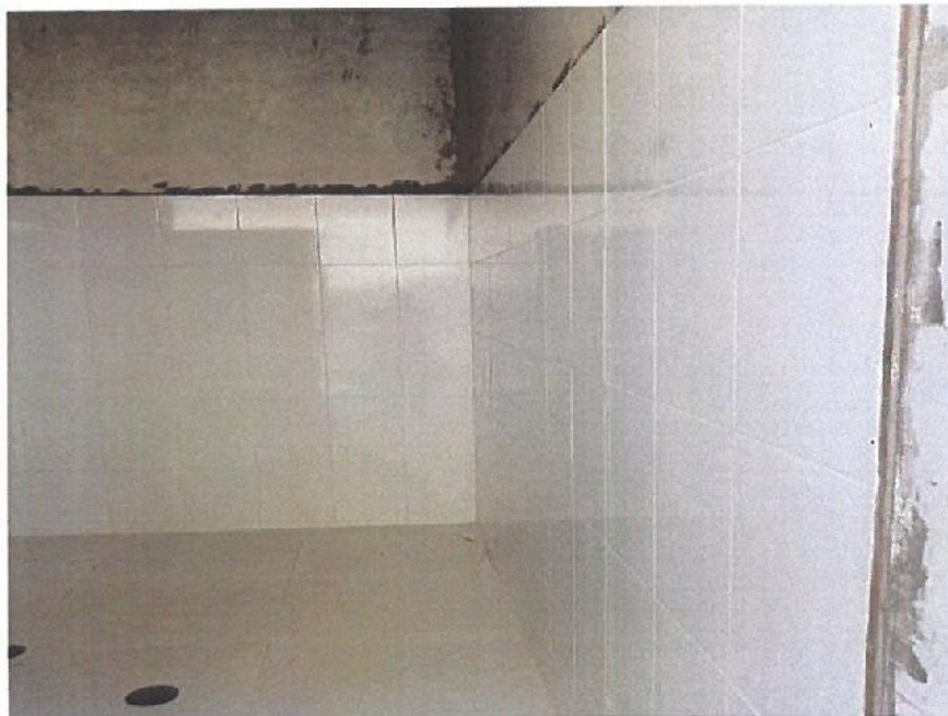
EN LA FIGURA SE OBSERVA EL ENCHAPADO DE LOS ZOCALOS DE MAYOLICA EN LOS S.S.H.H ZONA DE REFACCION
