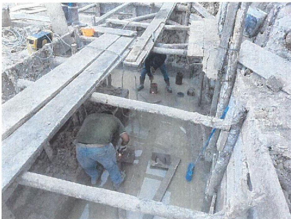
EN LA FIGURA SE MUESTRA LA COLOCACION DE PLANCHA PARA PILOTE A CADA 1.5 M.
