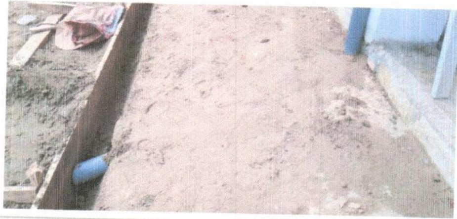
Tubería en sistema de drenaje pluvial
