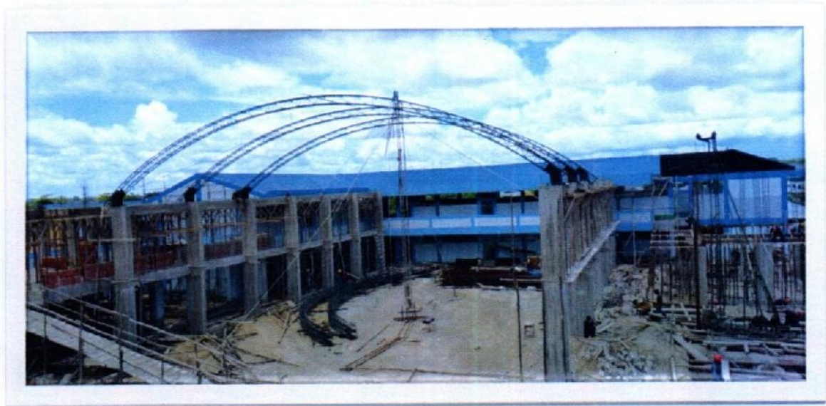
Vista panorámica de los trabajos de colocación de estructuras metálicas en el patio de formación
