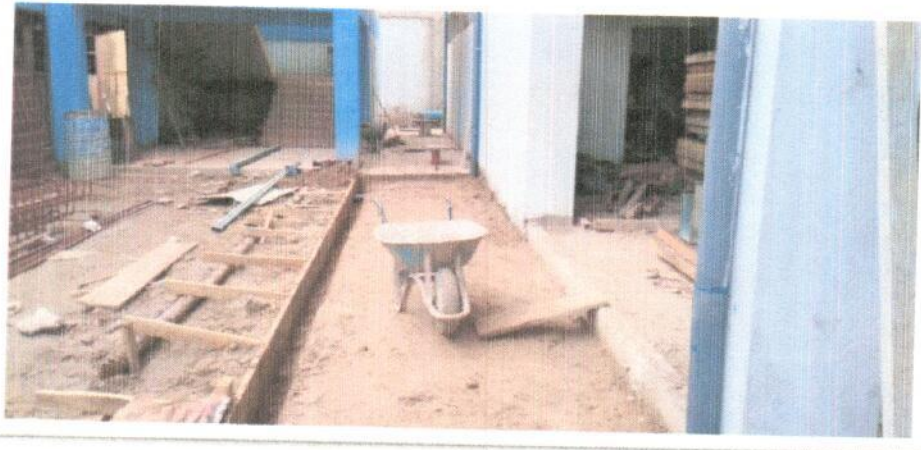
Tubería en sistema de drenaje pluvial
