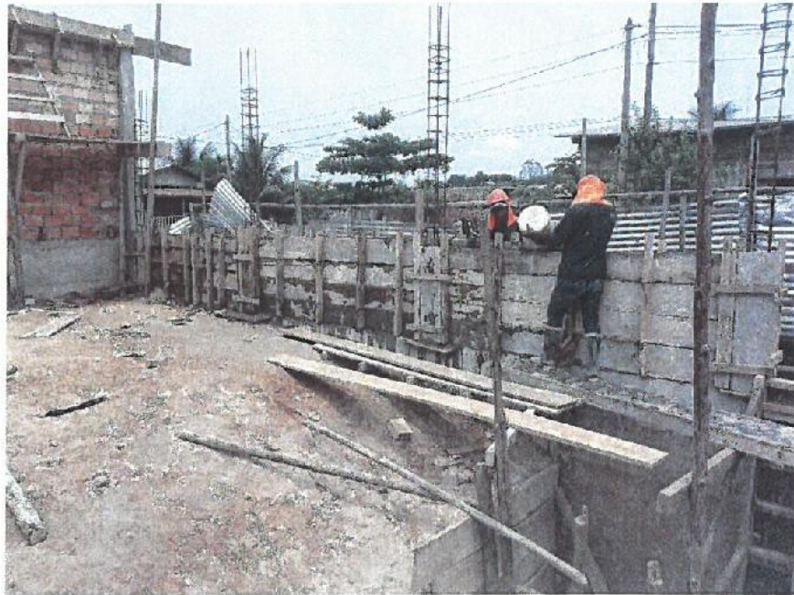
EN LA FIGURA SE MUESTRA LA PARTIDA VACEO DE SARDINEL DEL CERCO PERIMETRICO .
