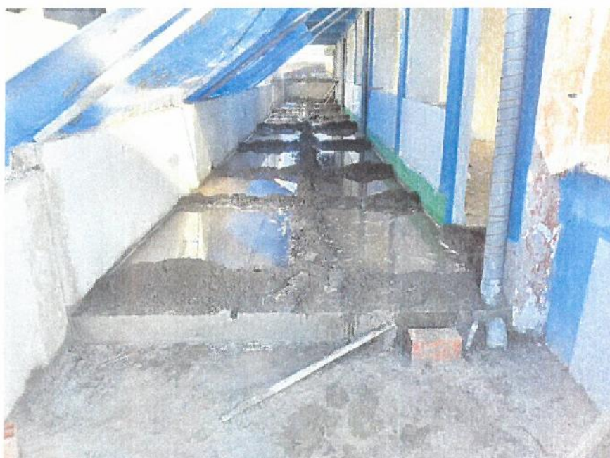
EN LA FIGURA SE OBSERVA CURADO DE PISO CON ARROCERA EN EL SEGUNDO PISO DEL PABELLON EXISTENTE
