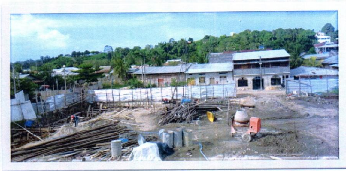
Vista panorámica a la zona de muro de contención para cerco perimétrico
